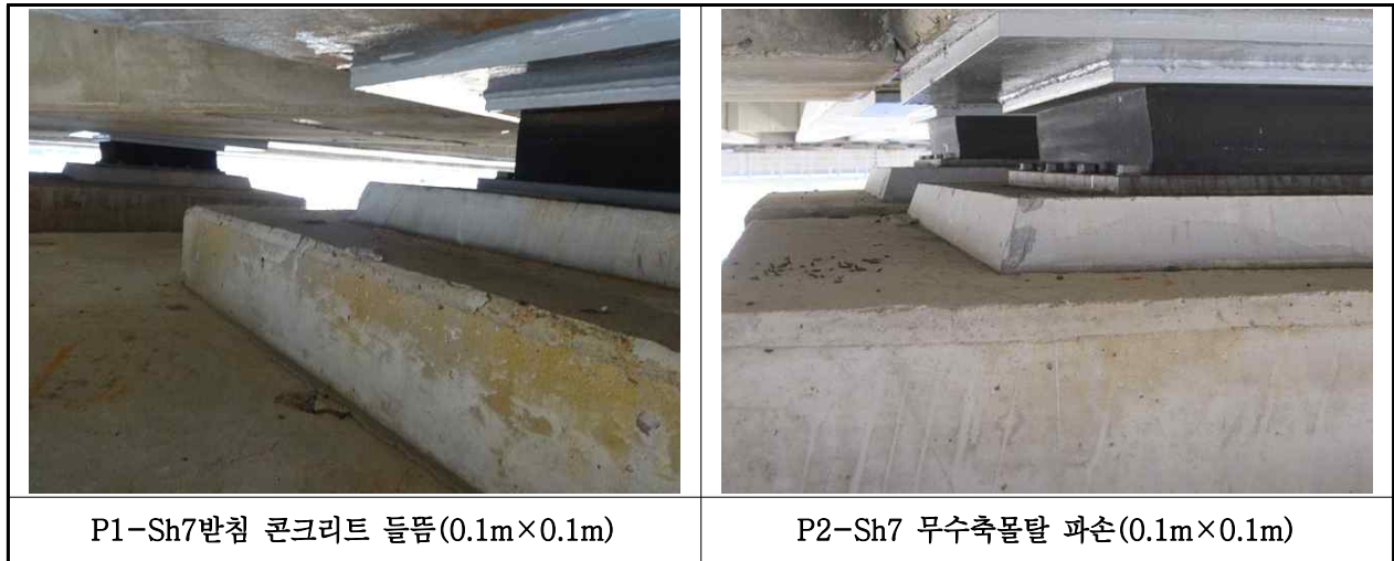
【사진 4.3.39】 교량받침 손상현황(계속)
