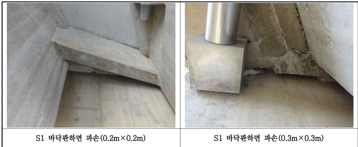
【사진 4.3.28】 바닥판하면 손상현황
