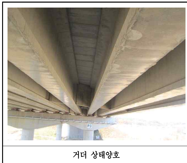
【사진 4.3.5】 거더 손상현황
