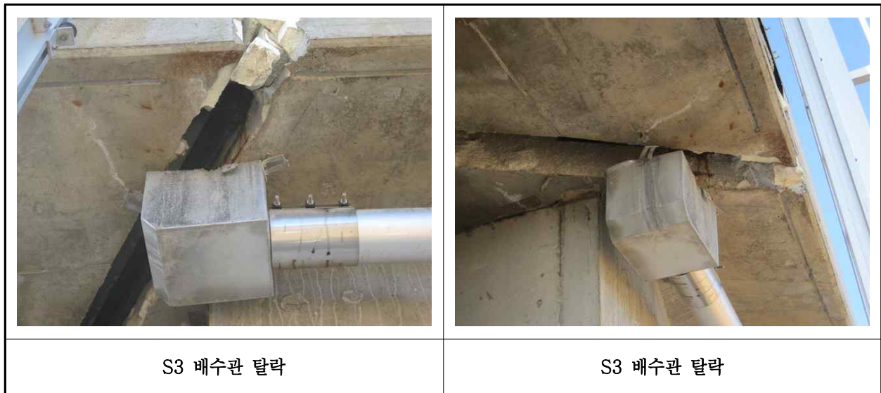
【사진 4.3.22】 배수시설 손상현황
