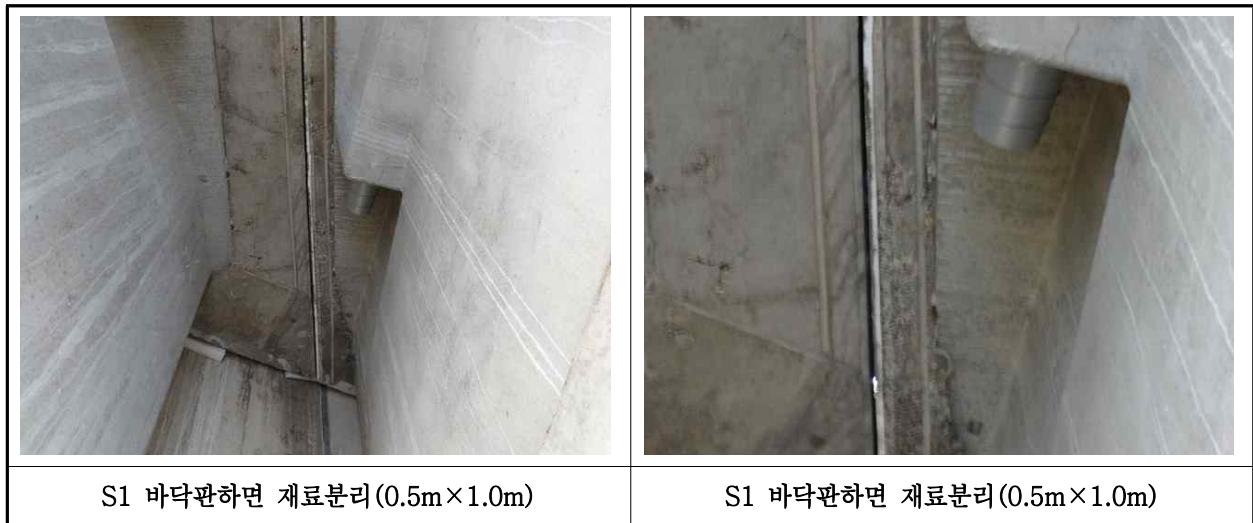
【사진 4.3.3】 바닥판하면 손상현황
