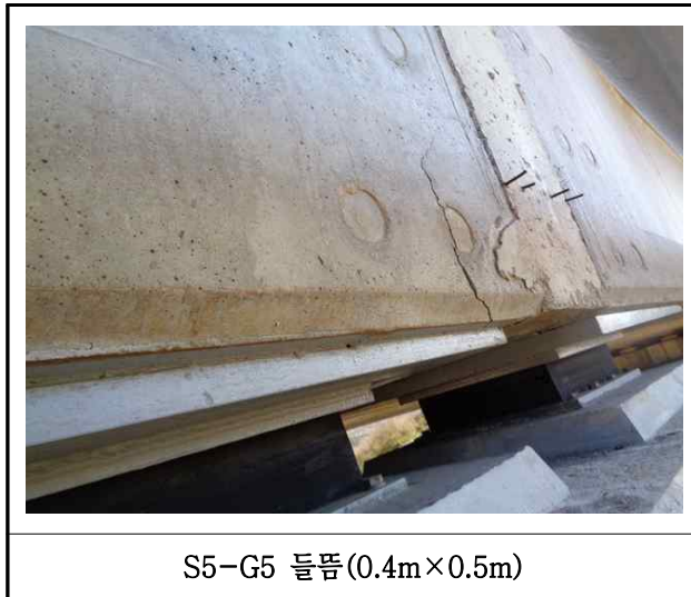
【사진 4.3.30】 거더 손상현황
