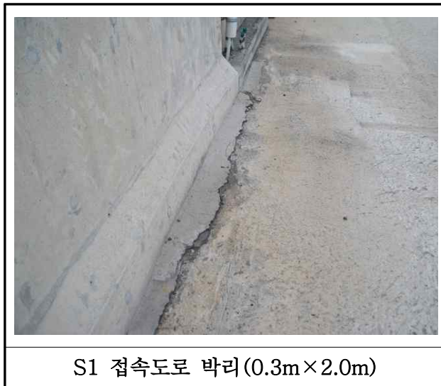
【사진 4.3.46】 교면포장 손상현황
