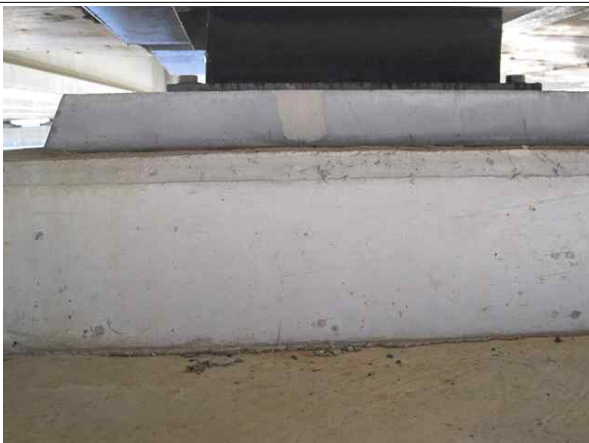
P2-Sh9 받침콘크리트 균열(0.1mm/0.3m)
