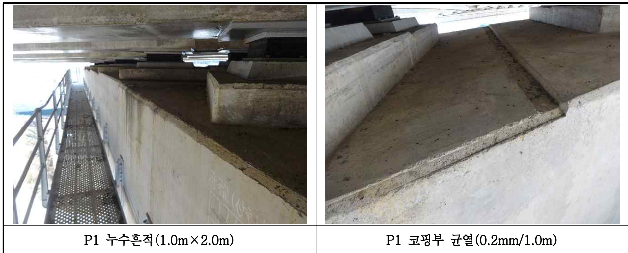
【사진 4.3.11】 교각 손상현황
